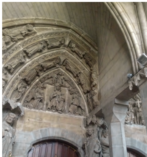
FIG. 27. DÉTAIL DU PORTAIL faisant apparaître le rouleau cassé de la voussure et sa retombée, assez gauche, sur le linteau formant séparation entre deux travées du cloître. Cl. B. Sournia.
