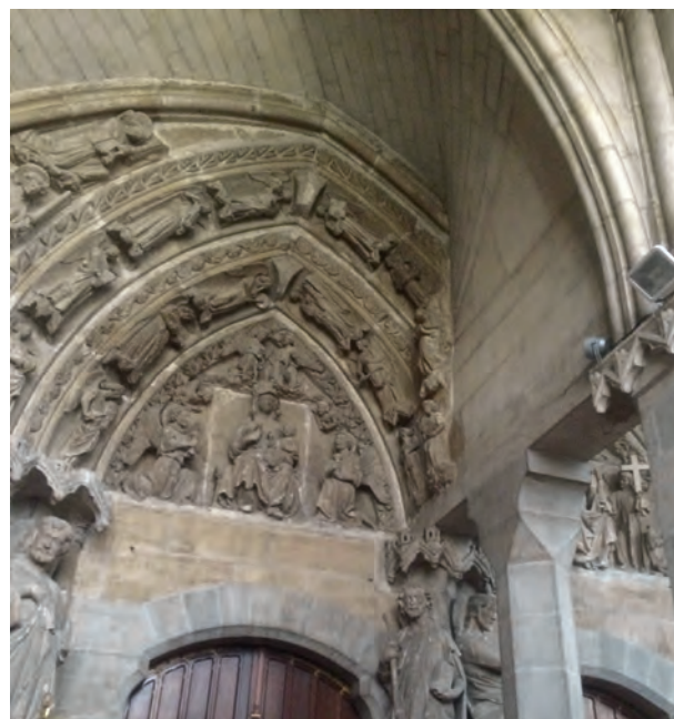
FIG. 27. DÉTAIL DU PORTAIL faisant apparaître le rouleau cassé de la voûture et sa retombée, assez gauche, sur le linteau formant séparation entre deux travées du cloître. Cl. B. Sournia.
