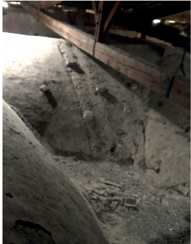
FIG. 6. VUE DE DÉTAIL DE LA MAÇONNERIE. Déliaison dans l'extrados des voûtes correspondant à la suture des deux campagnes.
