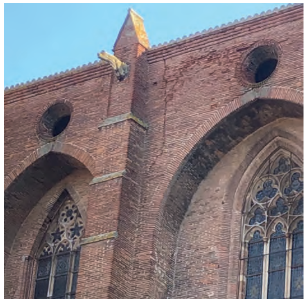
FIG. 7. « RESSAUT » DE BRIQUE À LA SUTURE DES DEUX CAMPAGNES de travaux sur les deux faces opposées sud et nord de l'église. Sur toute l'élévation dudit « ressaut » apparaît la profonde fissure ou déliaison de cette structure, manifestement maçonnée a posteriori et « collée » contre le contrefort. Cl. B. Sournia.
