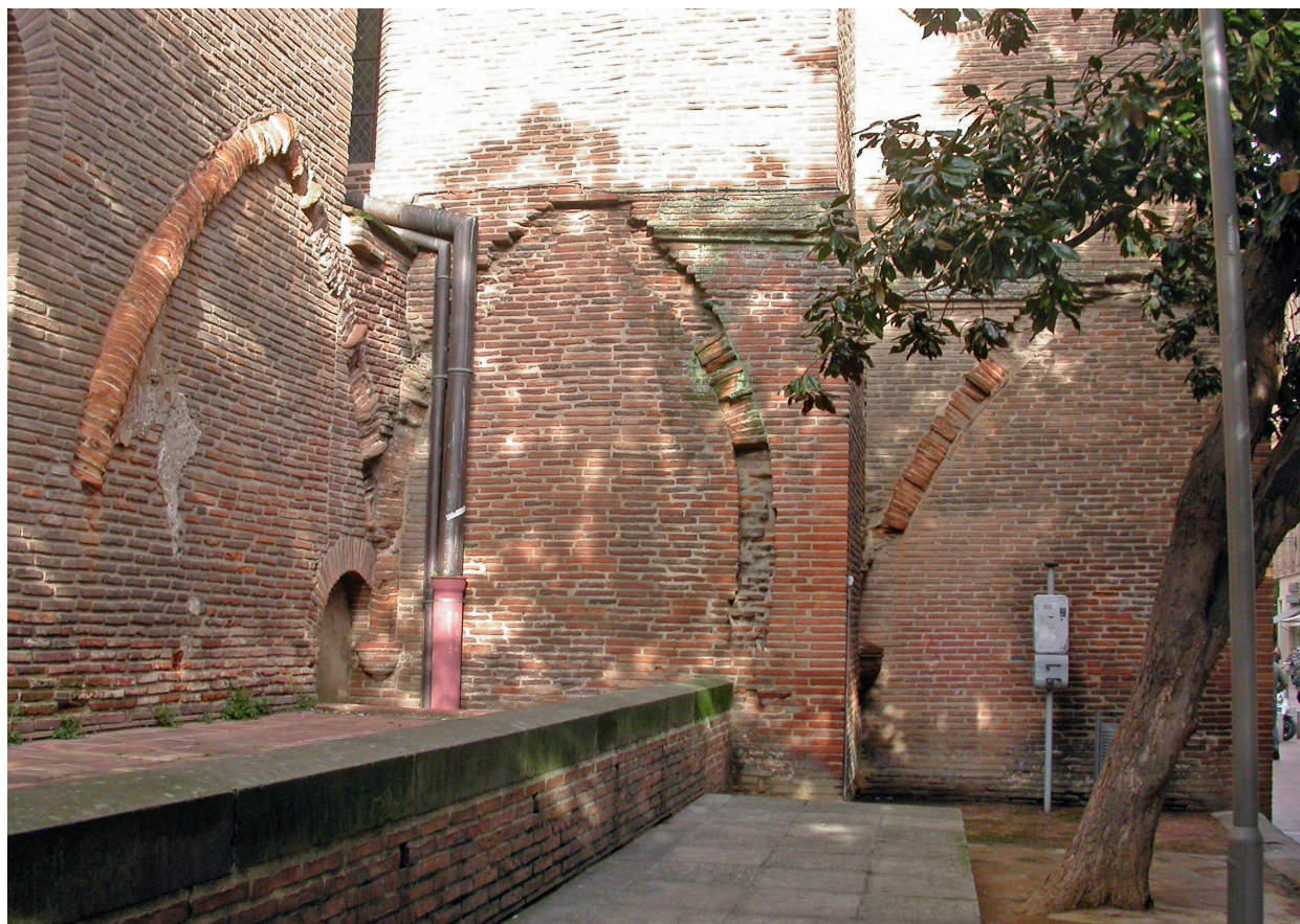
FIG. 1 : CHAPELLE DU SÉPULCRE, mur sud présentant une rupture d'appareil verticale. Cl. J. Dubois.
